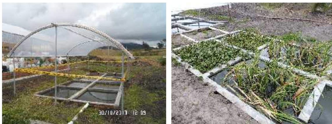
Figura 85 Fotografías de la planta de tratamiento de aguas de aguas residuales
