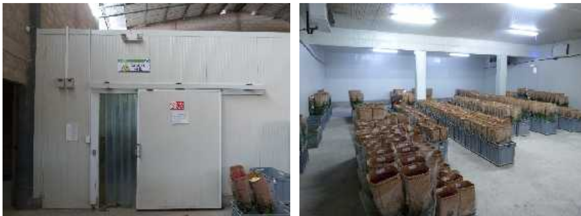
Figura 68 Fotografías del cuarto frío
