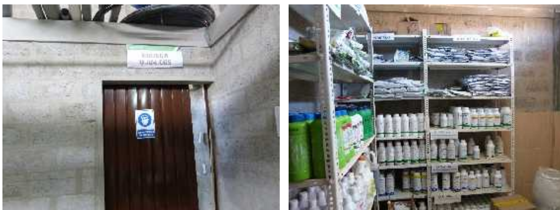
Figura 73 Fotografías de la bodega de químicos
